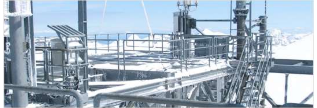
Kommunikations- und Sicherheitsanlagen
